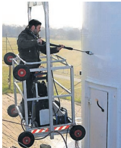
Erst wird die „Dicke Berta“ mit der Bürste abgeschrubbt, dann mit dem Hochdruckreiniger abgedampft.
